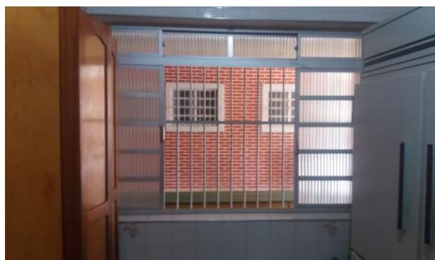
Foto 05 – A foto demonstra a janela do depósito onde estão os alimentos, sem tela de proteção - Escola Maria auxiliadora B. F. da cunha.
