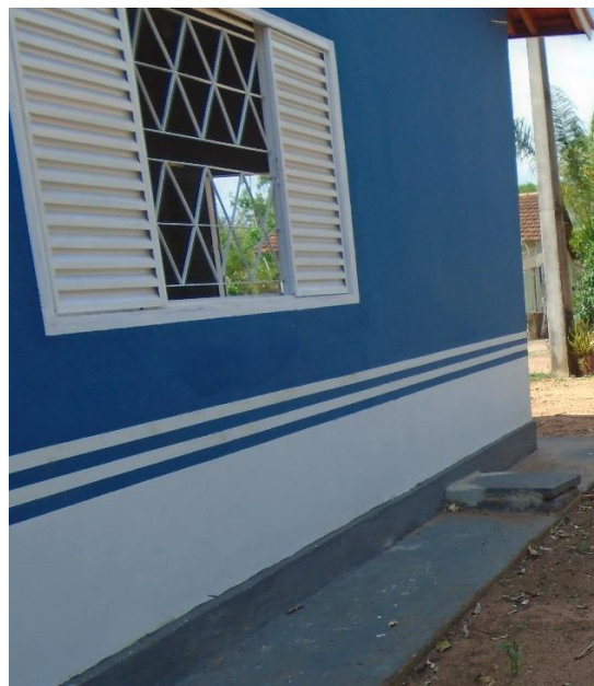
Foto 04 – Janela sem tela de proteção de insetos, localizada na cozinha, ambiente de preparo dos alimentos, onde está o fogão e a pia, etc. – Escola Alzira Correia dos Santos
