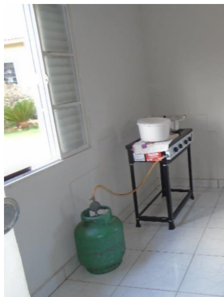
Foto 02 - Botijão de gás dentro da cozinha (sem abrigo na parte exterior da edificação NBR 13.523) – Escola Alzira Correia dos Santos.
