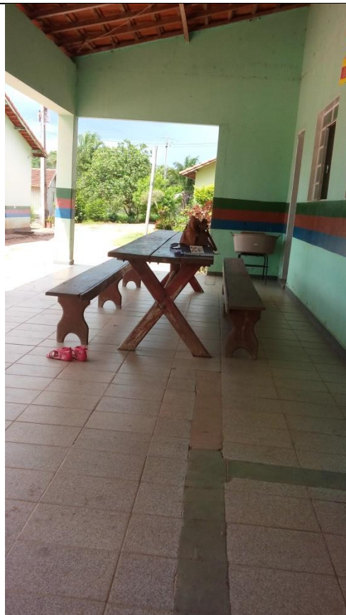
Foto 08 – Refeitorio com piso inadequado (Item 4.1.3 da Resolução-RDC Anvisa 216/2004); Figueirópolis D'Oeste - MT, 25/10/2016.
