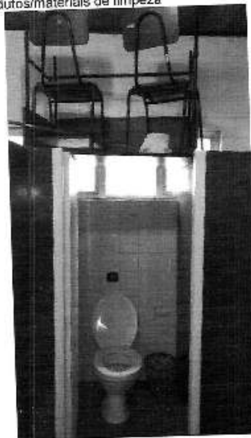
Foto: sanitário masculino – acúmulo de produtos/materiais de limpeza
