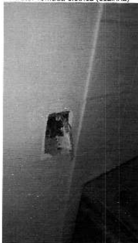
Foto: Tomada elétrica (cozinha)
