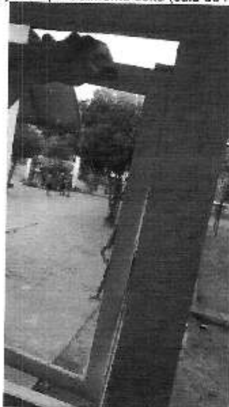
Foto: janela parcialmente solta (sala do Pré II)
