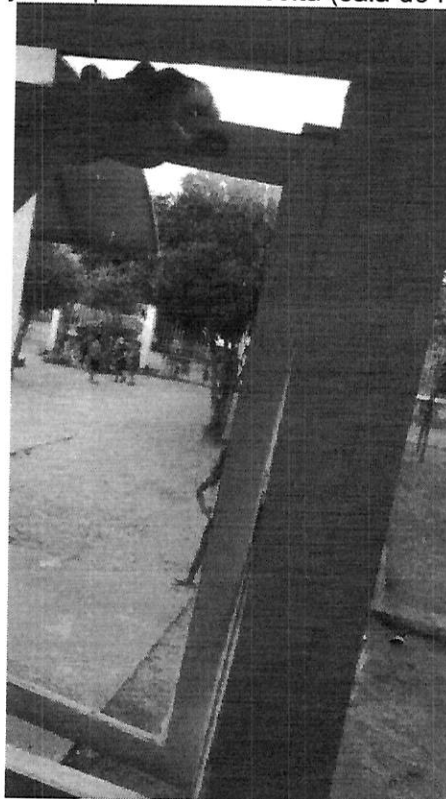
Foto: janela parcialmente solta (sala do Pré II)
