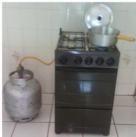
Foto 08 - Botijão de gás na cozinha (sem abrigo na parte exterior da edificação – NBR/ABNT 13523), Escola Maria Auxiliadora (creche), Figueiropolis D'Oeste - MT (MT), 21/10/2016.
