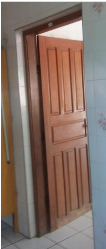
Foto 01 – Porta que dá acesso a cozinha sem proteção nas aberturas inferiores para impedir a entrada de insetos e roedores e sem fechamento automático, com livre acesso aos funcionários da escola, (item 4.1.4 da Resolução-RDC Anvisa 216/2004). Escola Maria Auxiliadora (creche), Figueirópolis D'Oeste - MT (MT), 21/10/2016.
