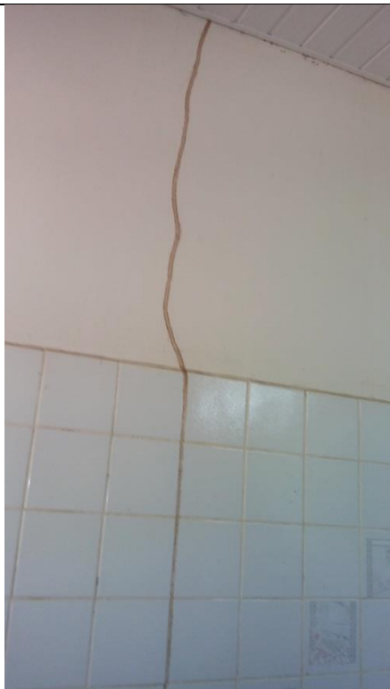
Foto 05 – Paredes internas com bolores, sujas e forro com infiltração caindo resíduos e exalando mal cheiro do teto, (item 4.7.6 da Resolução-RDC Anvisa 216/2004), Figueiropolis D'Oeste - MT, 25/10/2016.
