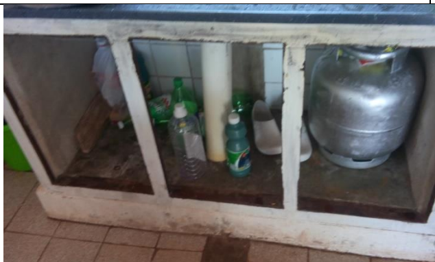
Foto 03 – Botijão reserva em local impróprio (sem abrigo) na parte exterior da edificação – NBR/ABNT 13523), Figueirópolis D'Oeste - MT, 25/10/2016.
