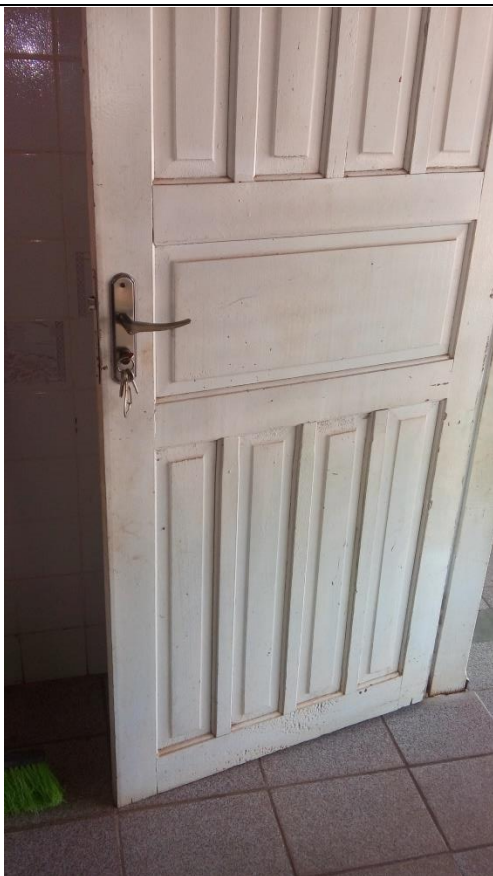
Foto 07 – Porta da cozinha sem proteção nas aberturas inferiores para impedir a entrada de insetos e roedores e sem fechamento automático (item 4.1.4 da Resolução-RDC Anvisa 216/2004). Figueirópolis D'Oeste - MT, 25/10/2016.
