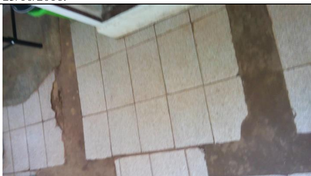
Foto 09 – piso da cozinha escolar inadequado (item 4.1.3 da Resolução-RDC Anvisa 216/2004), Figueirópolis D'Oeste - MT, 25/10/2016.
