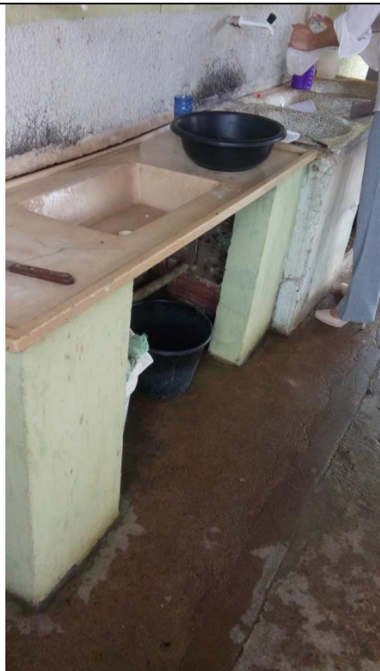
Foto 13 – local de lavar alimentos inadequado (item 4.4.1 da Resolução-RDC Anvisa 216/2004, Figueiropolis D'Oeste - MT, 26/10/2016.
