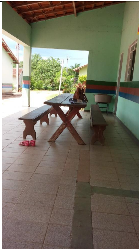
Foto 08 – Refeitório com piso inadequado (Item 4.1.3 da Resolução-RDC Anvisa 216/2004); Figueirópolis D'Oeste - MT, 25/10/2016.
