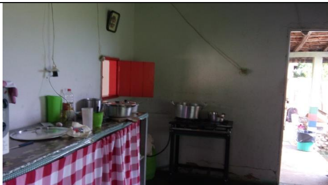
Foto 11 – Pintura de parede descascada do local de armazenamento (item 4.1.3 da Resolução-RDC Anvisa 216/2004) com fiação exposta (item 4.1.9 da Resolução-RDC Anvisa 216/2004), Figueiropolis D'Oeste - MT, 26/10/2016.
