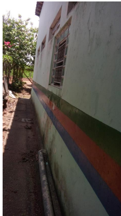
Foto 06 – Paredes externas com bolores, (item 4.7.6 da Resolução-RDC Anvisa 216/2004), Figueiropolis D'Oeste - MT, 25/10/2016.
